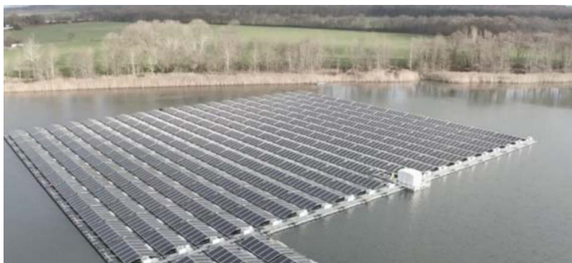
Figure 3. Exemple de centrale photovoltaïques flottantes utilisant des structures Zimmermann (source : Zimmermann)
