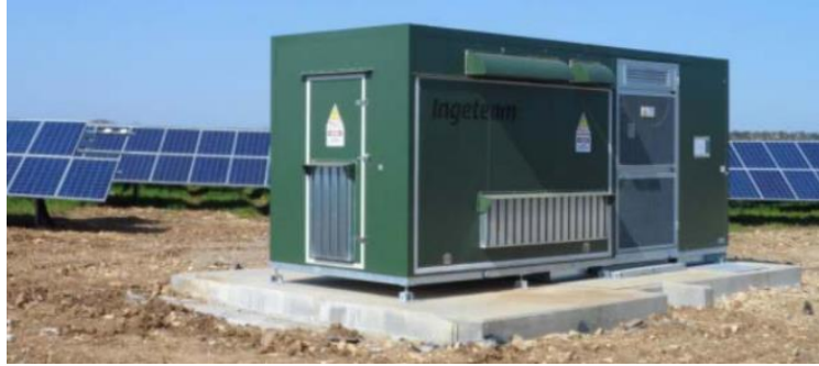
Figure 7. Exemple de local technique transformateur type (Source : INGETEAM)
